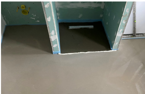
Bild 1: Gipsbauplatten ohne Abdichtung in Feuchträumen
